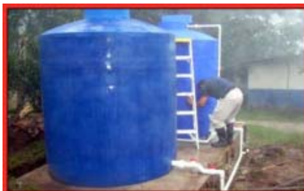
PANAMÁ: LA COMUNIDAD AYUDÓ CON CEMENTO Y MANO DE OBRA A FIN DE CONSTRUIR ESTE SISTEMA DE DISTRIBUCIÓN DE AGUA POTABLE A TRAVÉS DEL PROYECTO DE AGUA EN HATO CHAMÍ- CHIRIQUÍ.
